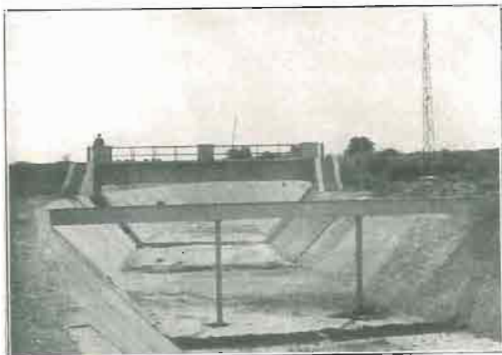
Paso sobre el Canal de una acequia de riego y en segundo término de la conducción de aguas para la Azucarera de Calahorra, (Sección I)
