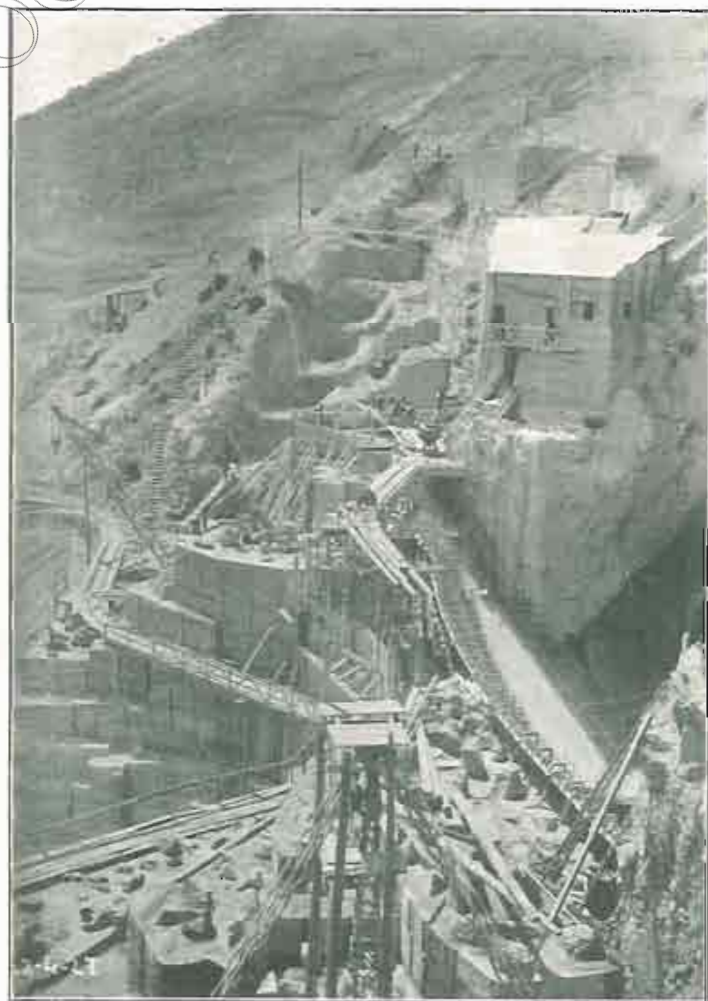
Detalle de la construcción de la presa, con la instalación de hormigoneras.
