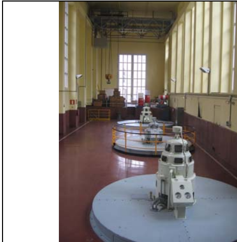
Central de Spot-Torrassa. Interior de las naves de turbinas. Se turbinan agua procedente del Noguera Pallaresa derivada en la presa de Torrassa y agua del Spot derivada en Spot. A partir de aquí y hasta Llavorsí el río no va a tener derivaciones de agua en un tramo prolongado (del orden de 7 km)
