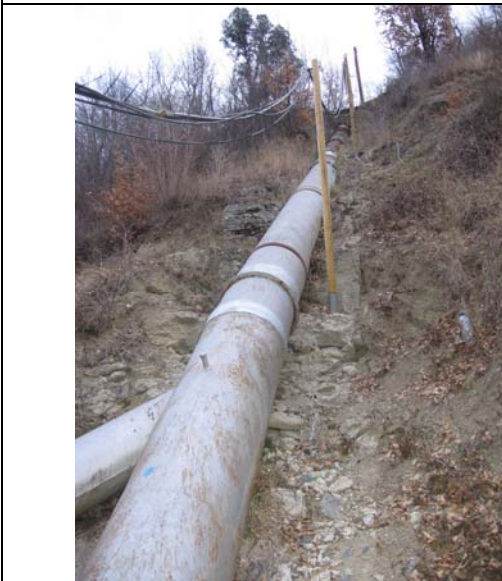
Central Hidroeléctrica de San Antonio en río San Antonio. Tubería que conduce el agua que va a ser turbinada
