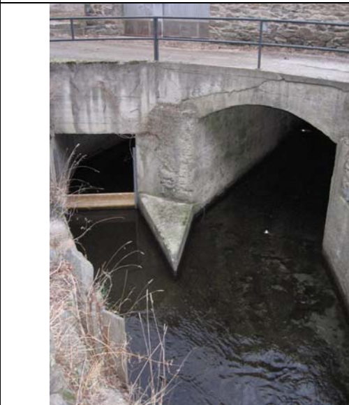
Central Hidroeléctrica de San Antonio en río San Antonio. Punto de salida del agua turbinada y de la que sale por el rebosadero de la cámara de carga
