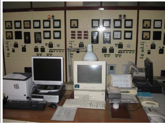
Central de Spot-Torrassa. Sala de control de la central
