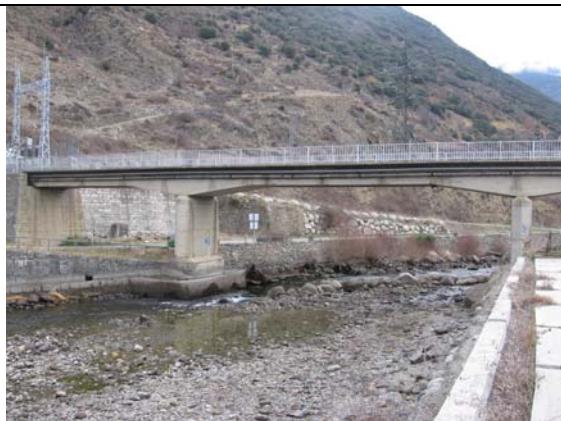
Canalización y central de Esterri+Unarre. Canalización de Sterri y azud de gravas al fondo
