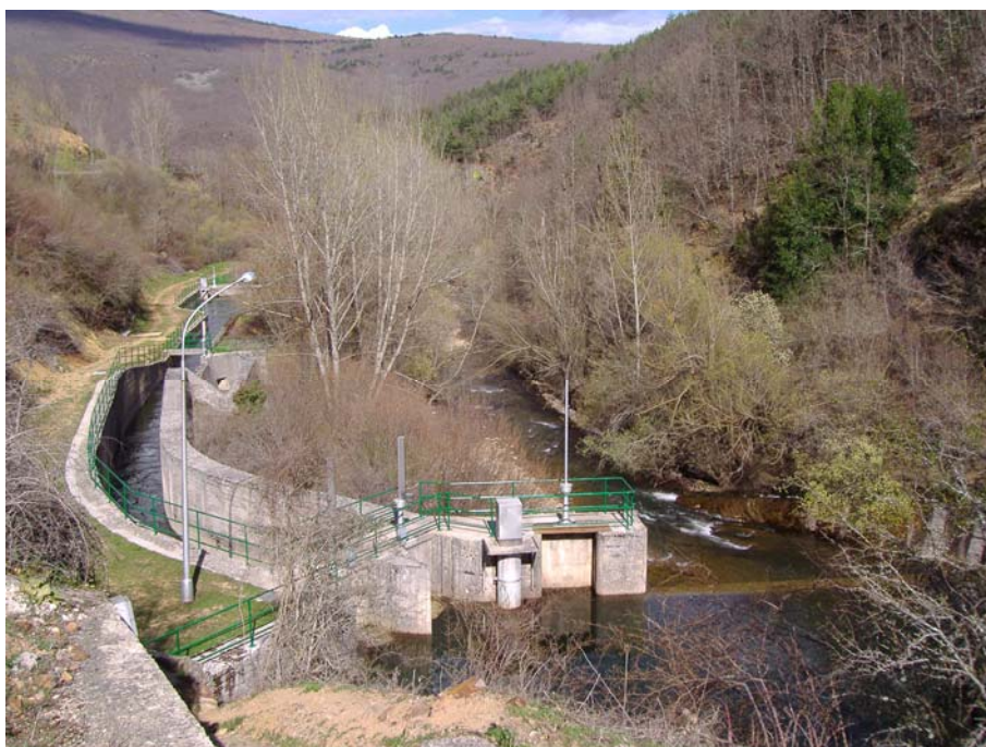
Ref. 53.- Azud y Toma del Canal Alimentador Traslase al Embalse de Ortigosa.
