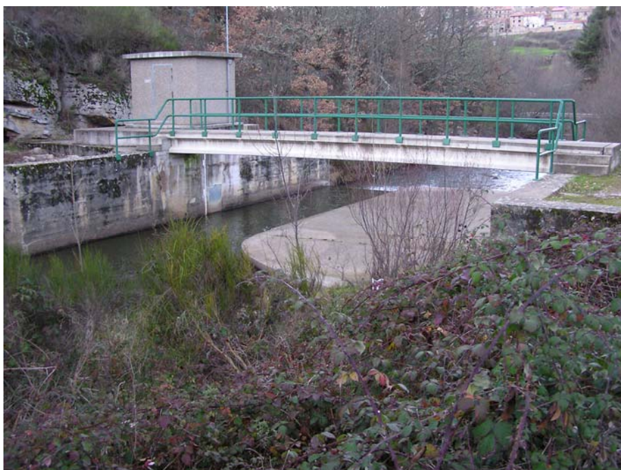
Ref. 26.- Estación de Aforos nº 142 en Lumbreras.
