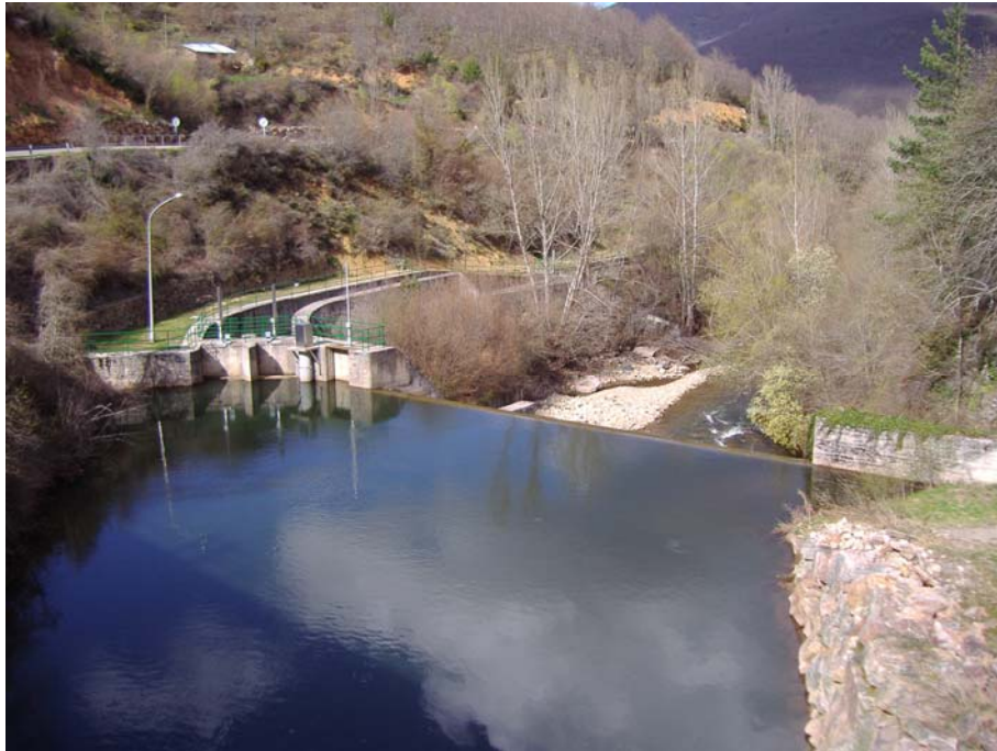
Ref. 47.- Azud y Toma del Canal Alimentador Traslase al Embalse de Ortigosa.
