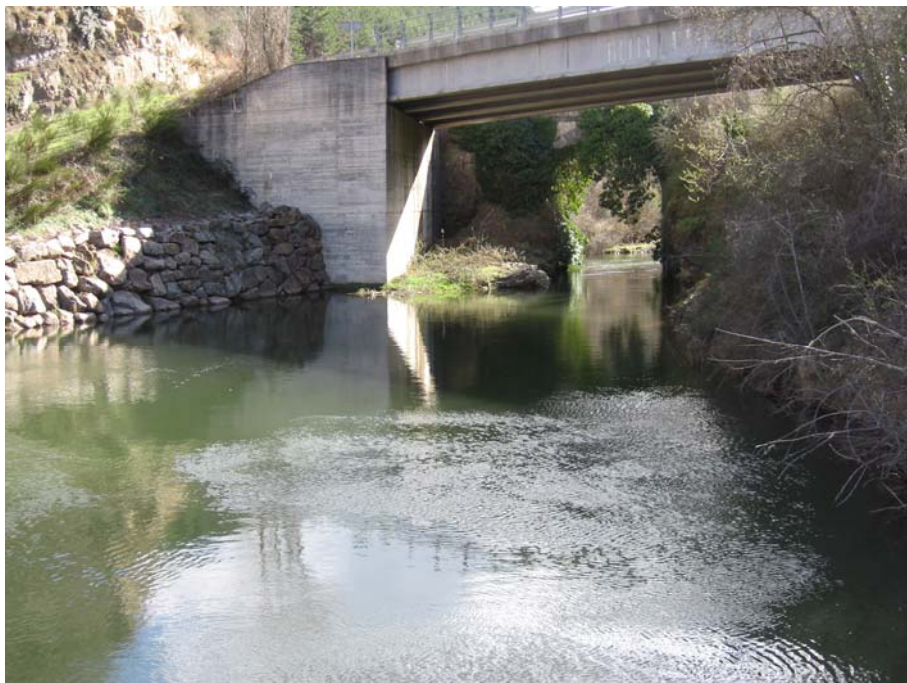
Ref. 44.- Puentes y Azud de la Toma del Canal Alimentador Traslase al Embalse de Ortigosa.
