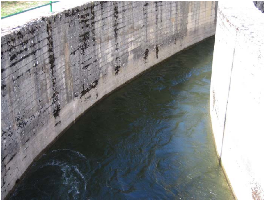
Ref. 43.- Toma del Canal Alimentador Traslase al Embalse de Ortigosa.
