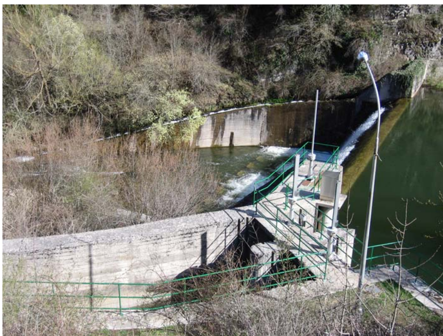
Ref. 40.- Azud y Toma del Canal Alimentador Traslase al Embalse de Ortigosa.
