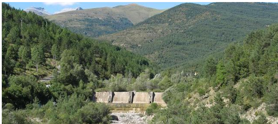
Figura 53-43. Presa de sedimentos colmatada en el cauce del río Aurín junto a la localidad de Isín.
