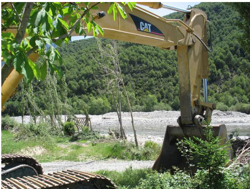
Figura 55-11. Extracciones de áridos aguas arriba de la localidad de Labuerda.
